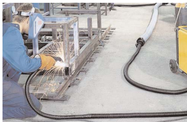
Aspirazione diretta di fumi di saldatura tramite torcia.
